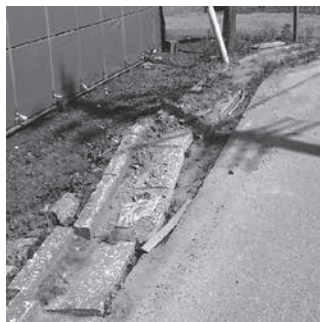
排水路(側溝)の破損①
