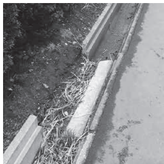
排水路(側溝)の破損②
