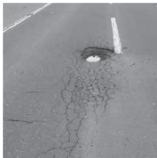
道路の穴ぼこ・段差
