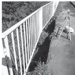
道路路肩の崩落
