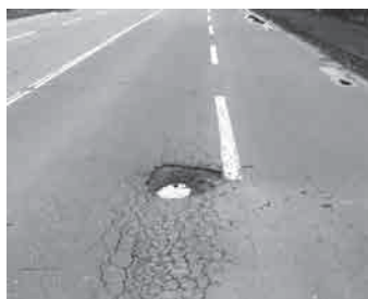
舗装の穴ぼこ・段差
