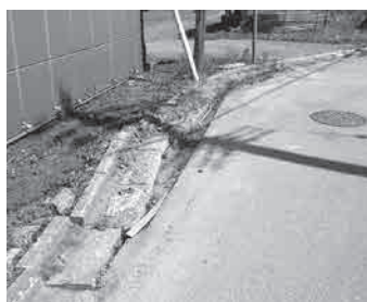
排水路(側溝)の破損①
