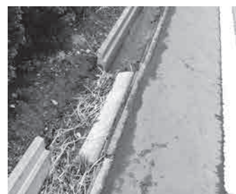
排水路(側溝)の破損②
