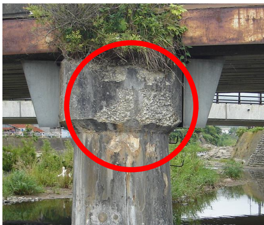
図3-4 凍害による損傷事例
