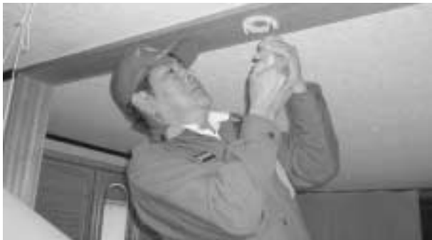
▲火災警報器を設置している様子
