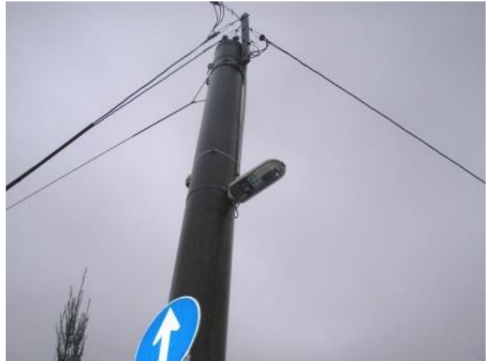
●道路照明灯が点灯していない。(防犯灯は除く)
