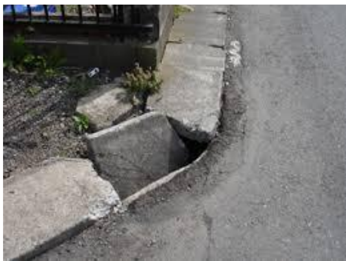
●側溝のふたが外れている。ふたが破損し落ちている。
