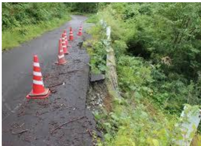
●路肩が崩れている。
