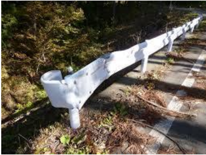
●ガードレールが壊れている。
