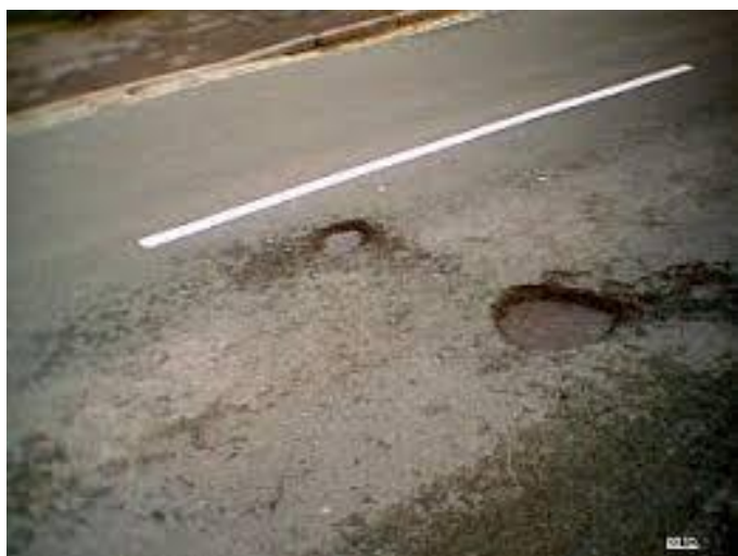
●舗装がはがれている。穴が開いている。
