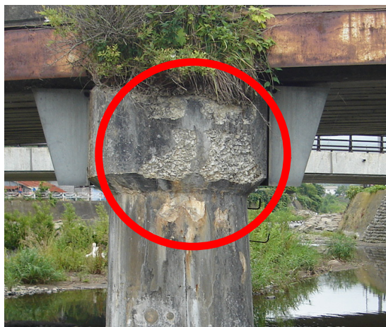
図3-4 凍害による損傷事例
