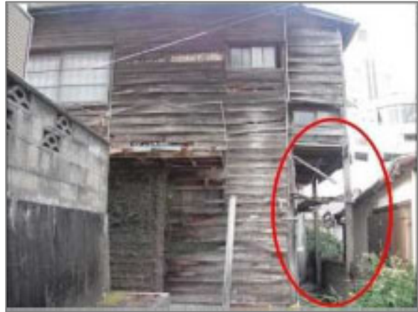
図 25:柱の数箇所に破損があり、倒壊等するおそれがある状態
