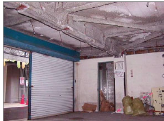
図 26:吹付け石綿等が飛散し暴露する可能性が高い状態
