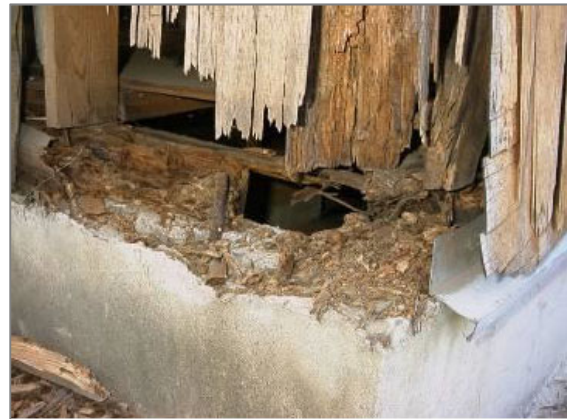
図 28:蟻害が発生し欠損している状態
