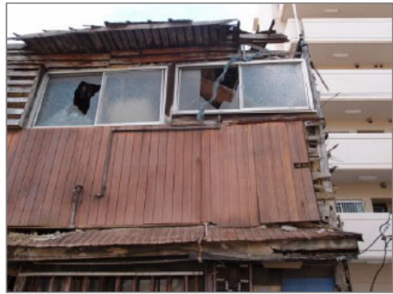
図 27:外壁、屋根ふき材が脱落し、景観を損なっている状態
